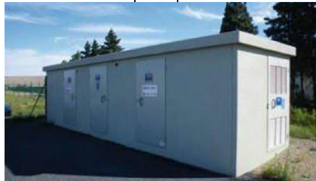
Illustration 14 : Exemple de poste de transformation
